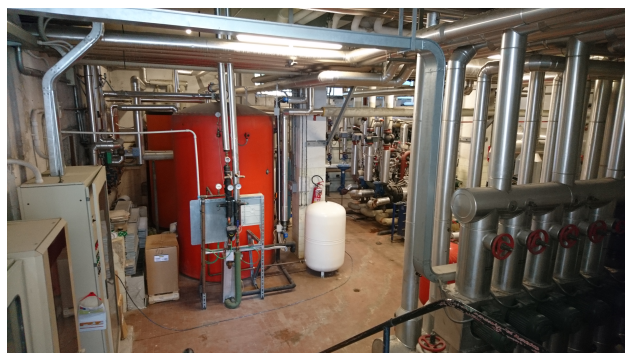
Sottocentrale termica allo stato attuale
