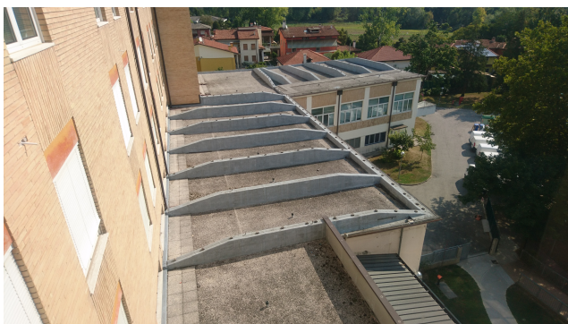
Copertura piana Corpo Centrale parte sud-est da coibentare
