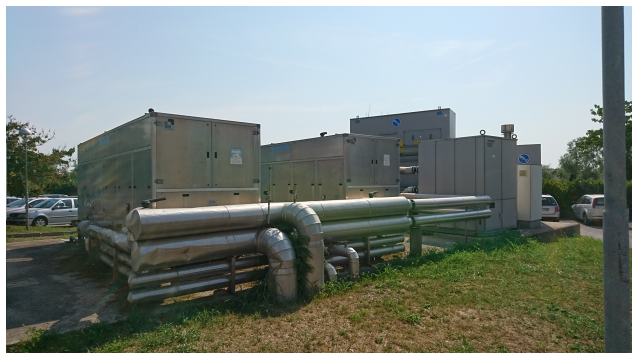
Impianti da sostituire nella medesima posizione
